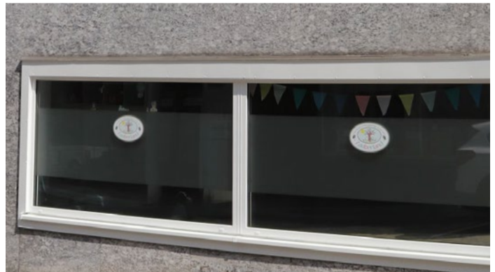
Gestörte Fassade, fehlende Untergliederung, liegendes Format
