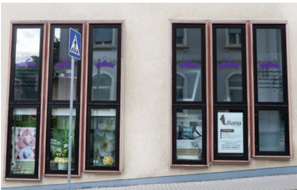
Gestörte Fassade, geschossübergreifend
